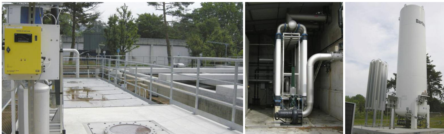
Les installations de la station d'épuration (STEP) de Lausanne-Vidy destinées à l'élimination des polluants chimiques en trace.
